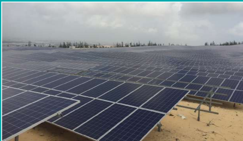
Nhà máy điện mặt trời Fujiwara Bình Định
