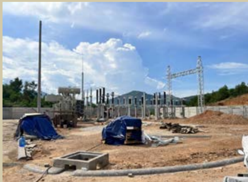
Công trình Trạm điện 110KV
