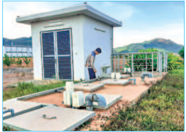
Hệ thống xử lý nước thải (sử dụng Wetland)
