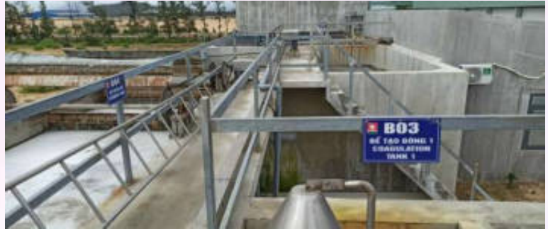
Hệ thống xử lý nước thải của Nhà máy chế biến hải sản đông lạnh An Hải
