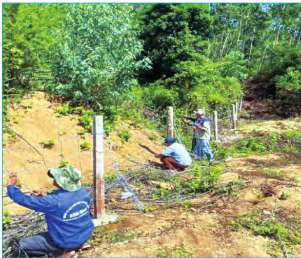
Xây dựng tường rào ngăn cách giữa KCN Phú Tài với khu vực phía Đông núi Hòn Chà
