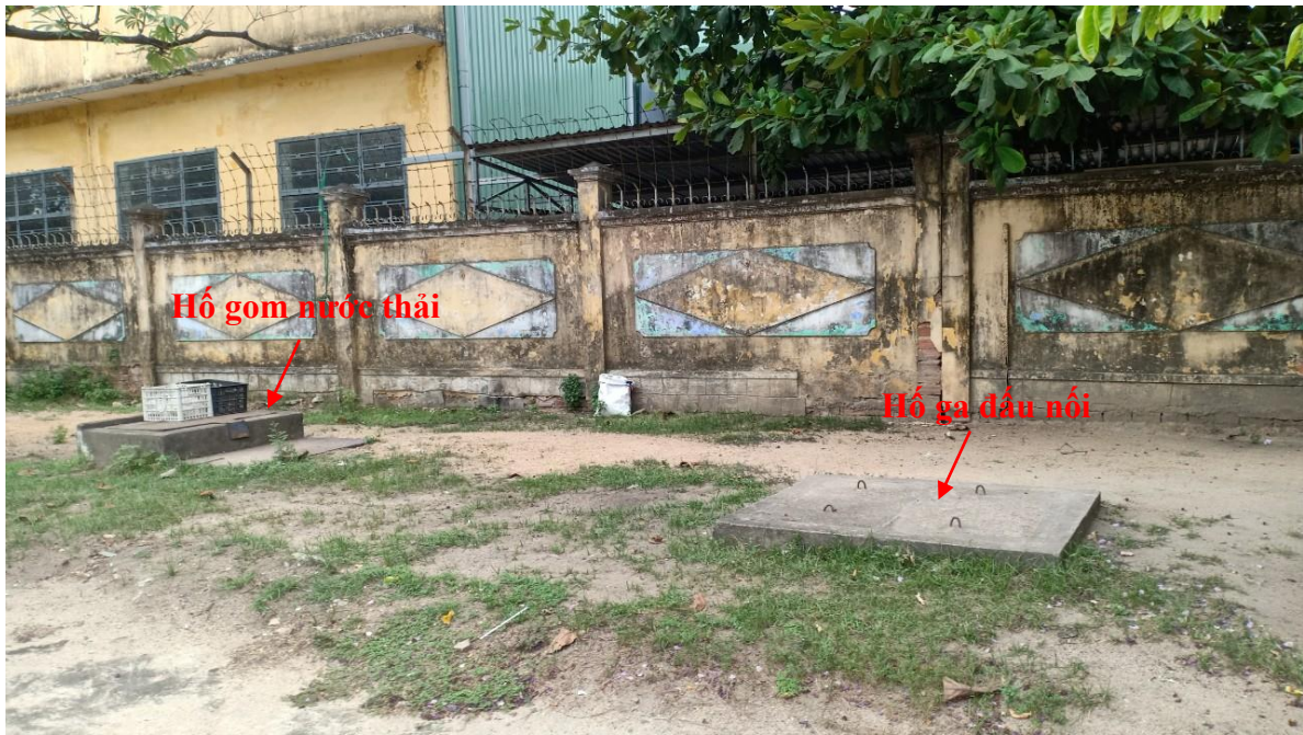
Hình 3.4. Hố gom nước thải và hố ga đầu nối nước thải của Nhà máy
