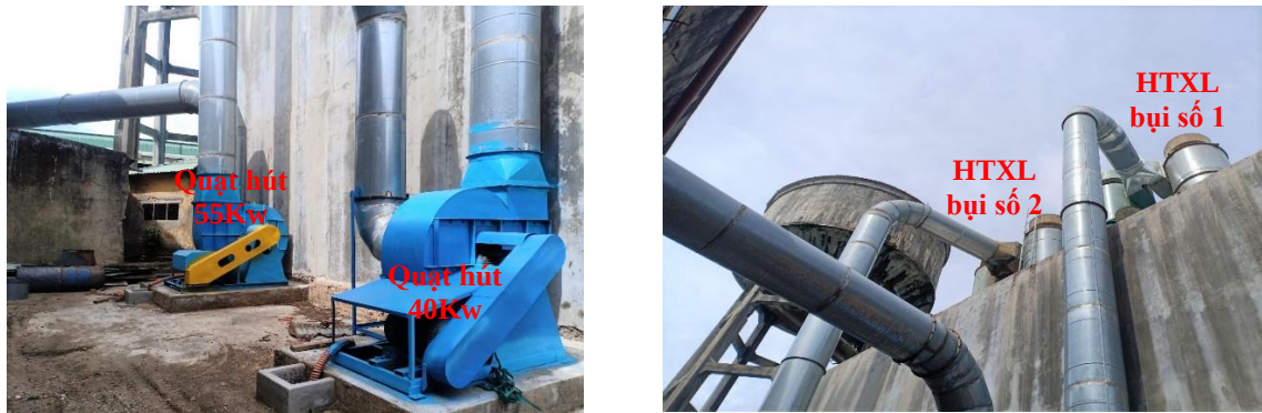
Hình 3.7. Hệ thống thu gom, xử lý bụi gỗ tại nhà máy
