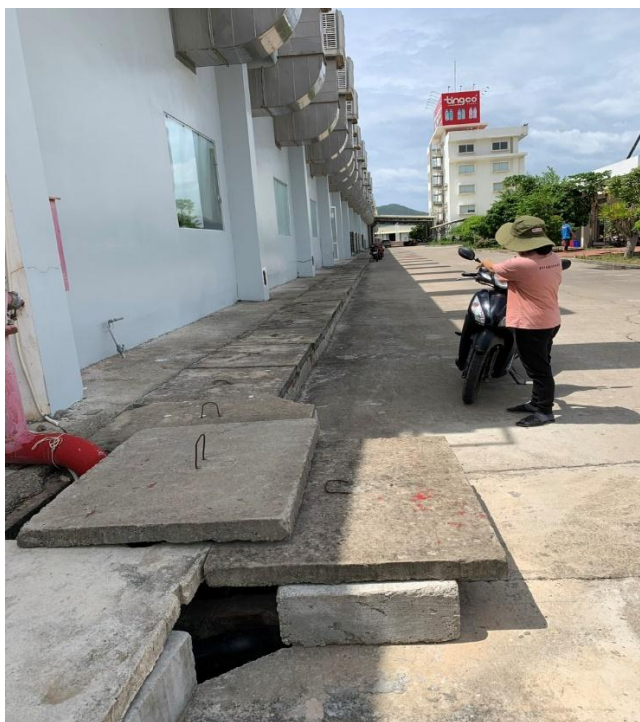
Hình 4.21. Hệ thống thu gom nước mưa quanh khu nhà kho thành phẩm của Nhà máy
