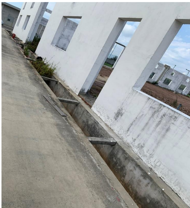
Hình 4.23. Hệ thống thu gom nước mưa quanh khu nhà kho đang xây dựng của Nhà máy
