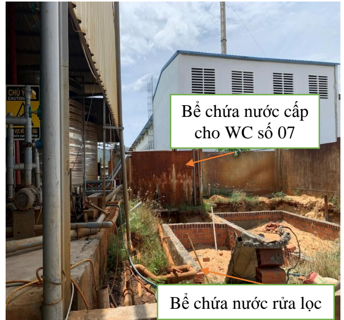
Hình 4.10. Bể chứa nước cấp cho nhà vệ sinh số 07 và bể chứa nước rửa lọc hệ RO của Nhà máy
