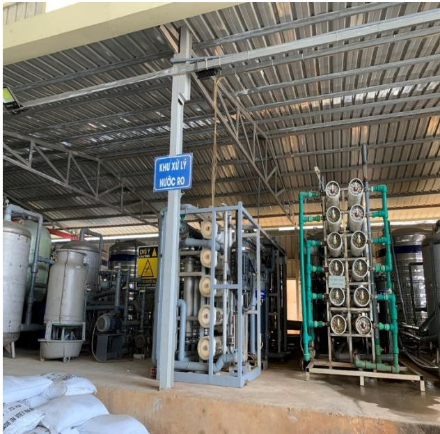
Hình 4.9. Khu vực xử lý nước RO của Nhà máy
