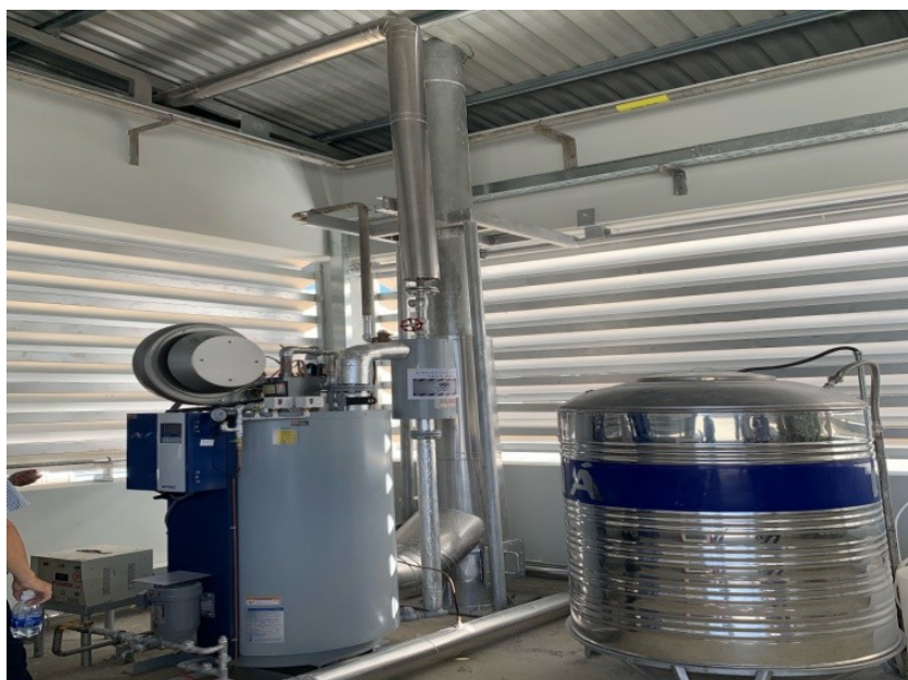
Hình 7. Lò hơi được lắp đặt tại nhà máy
