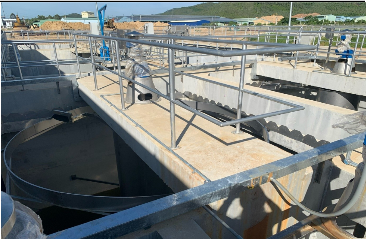
Hình 6. Một số hình ảnh về HTXL nước thải của nhà máy đã được lắp đặt
