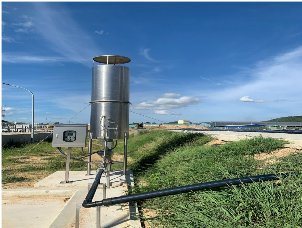
Hình 8. Thiết bị đốt khí biogas
