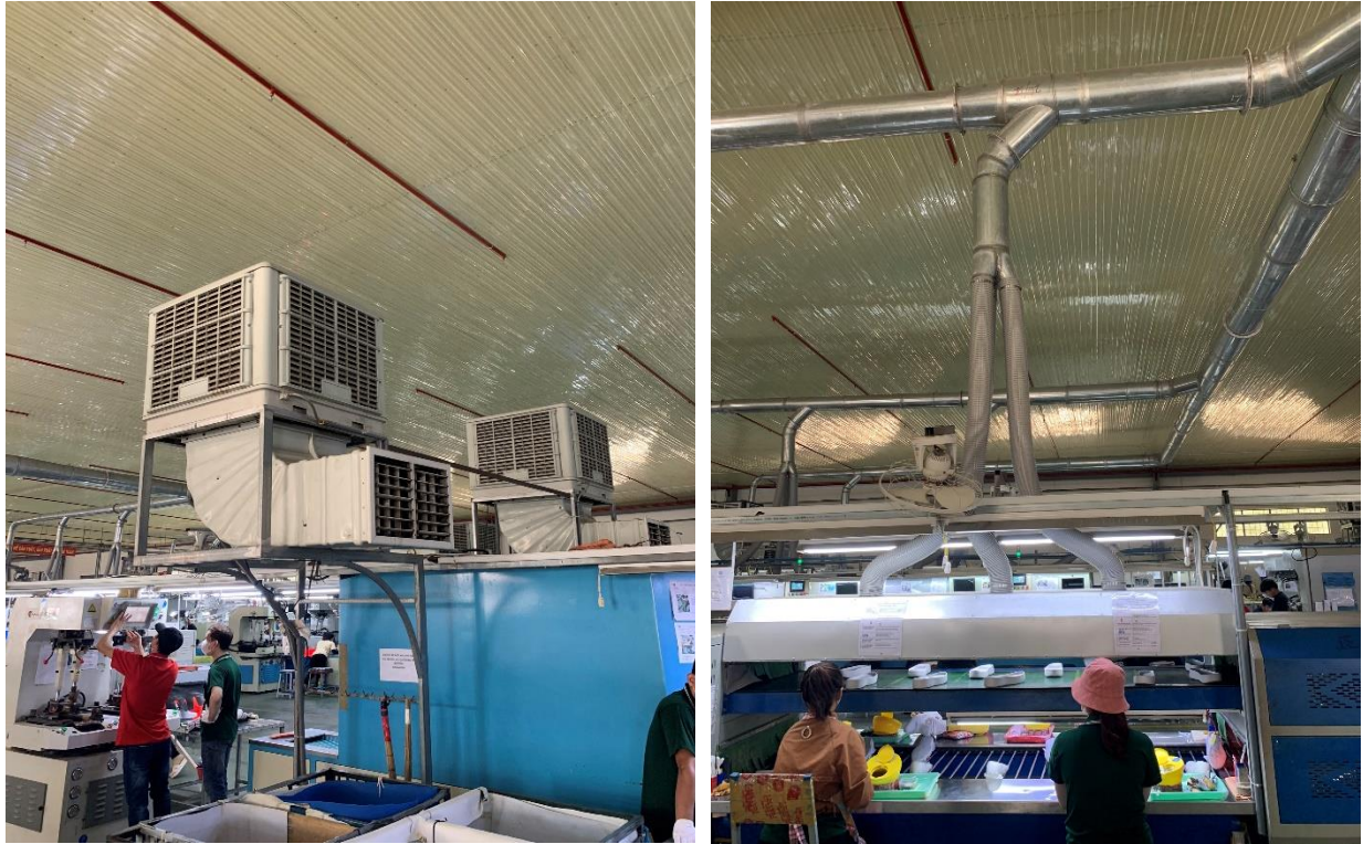
Hình 13. Quạt hút, các chụp hút được trang bị tại nhà máy
