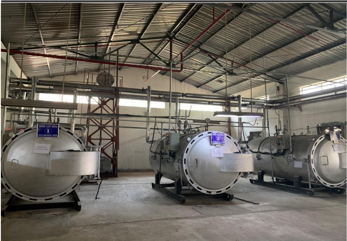
Hình 15. Bình lưu hoá cao su được lắp đặt tại cơ sở
