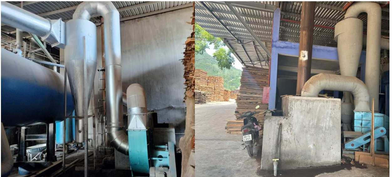
Hình 3.5. Hệ thống xử lý khí thải lò hơi
