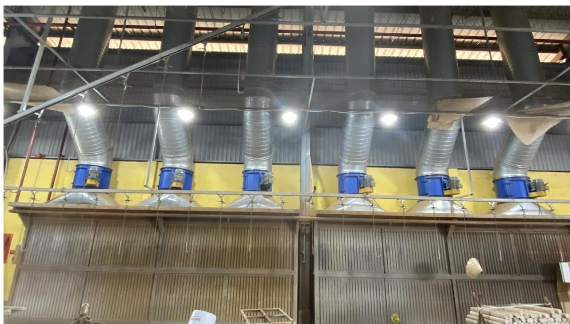
Hình 3.9. Hình ảnh 1 trong 2 hệ thống xử lý hơi dung môi, bụi sơn đặt cạnh tường nhà xưởng
