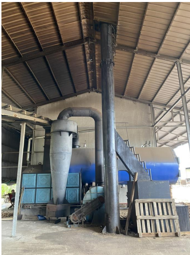
Hình 3.6. Hệ thống xử lý khói thải lò hơi tại cơ sở
