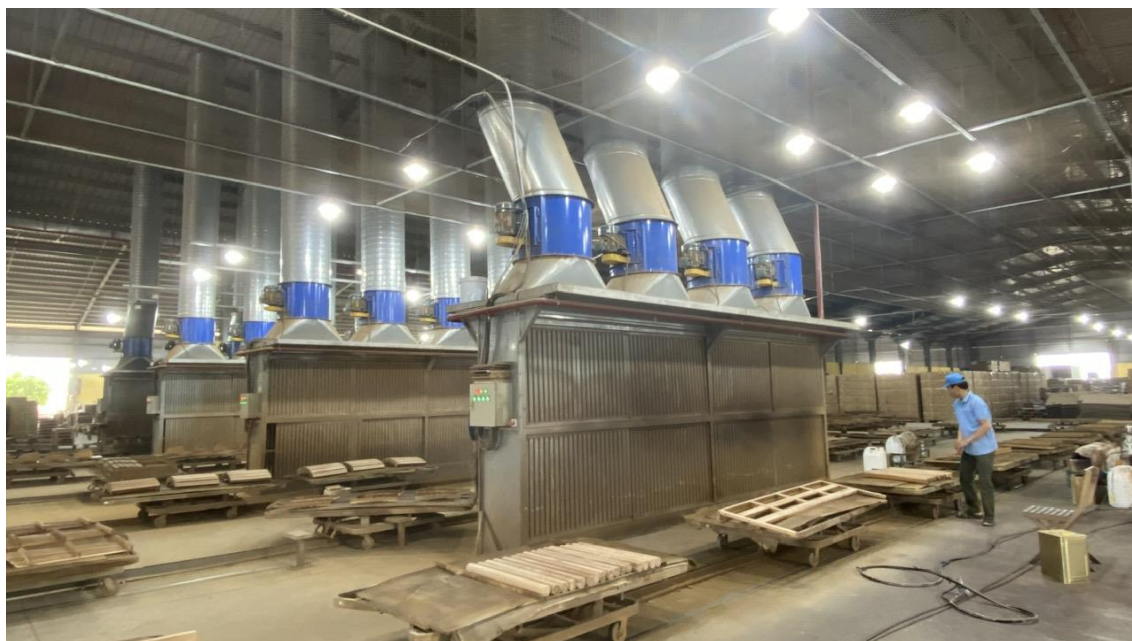
Hình 3.8. Hệ thống xử lý hơi dung môi, bụi sơn đặt giữa nhà xưởng
