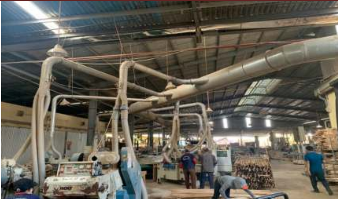
Hình 3. 7. Hệ thống thu gom và xử lý bụi nhà xưởng
