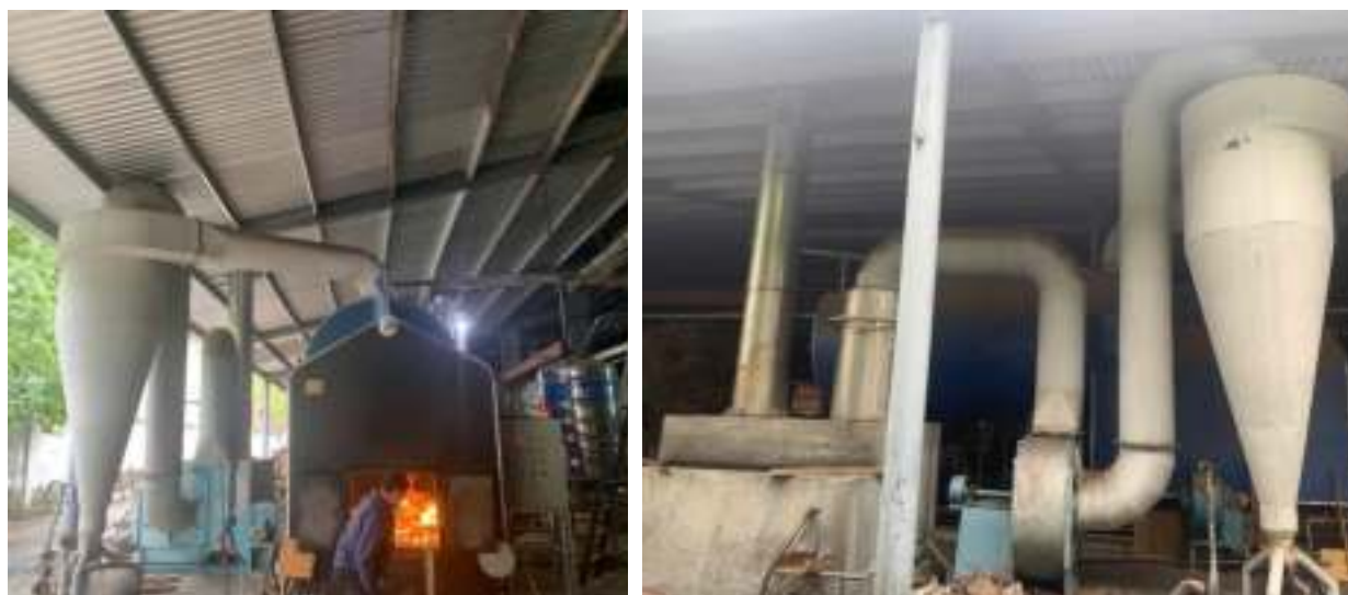
Hình 3. 9. Hệ thống xử lý khói thải nồi hơi
