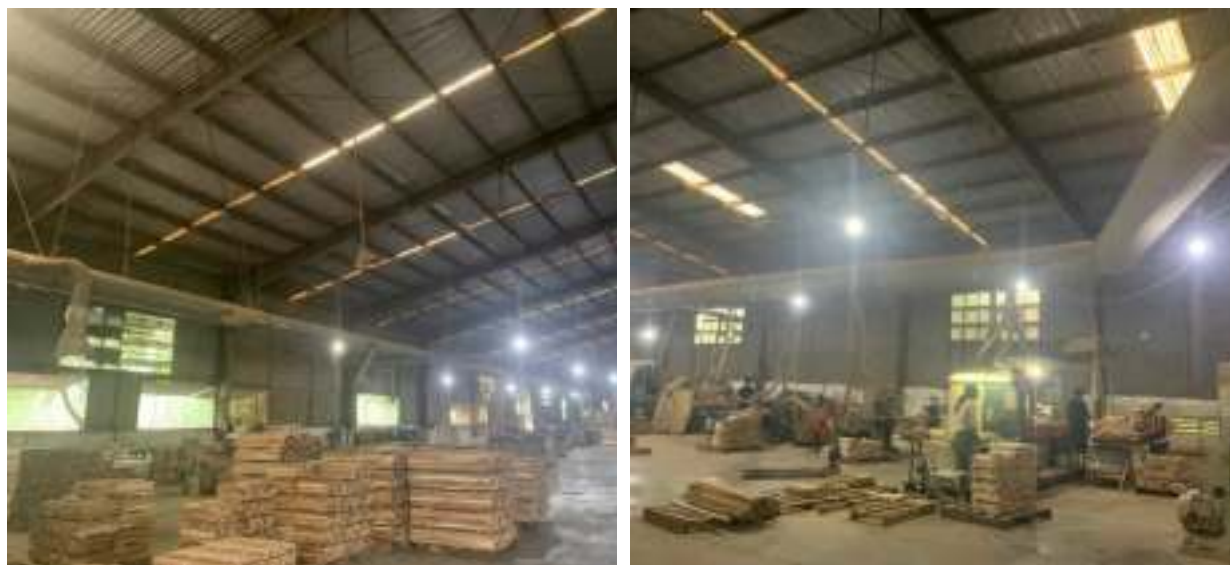
Hình 3. 7. Hệ thống thu gom và xử lý bụi nhà xưởng
