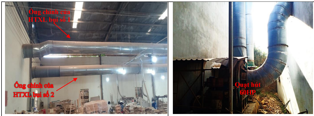
Hình 3.7. Hệ thống thu gom, xử lý bụi gỗ tại nhà máy
