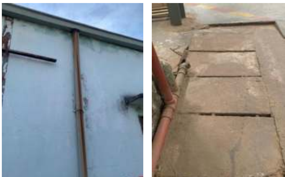
Hình 3. 2. Đường ống và mương thoát nước mưa của nhà xưởng
