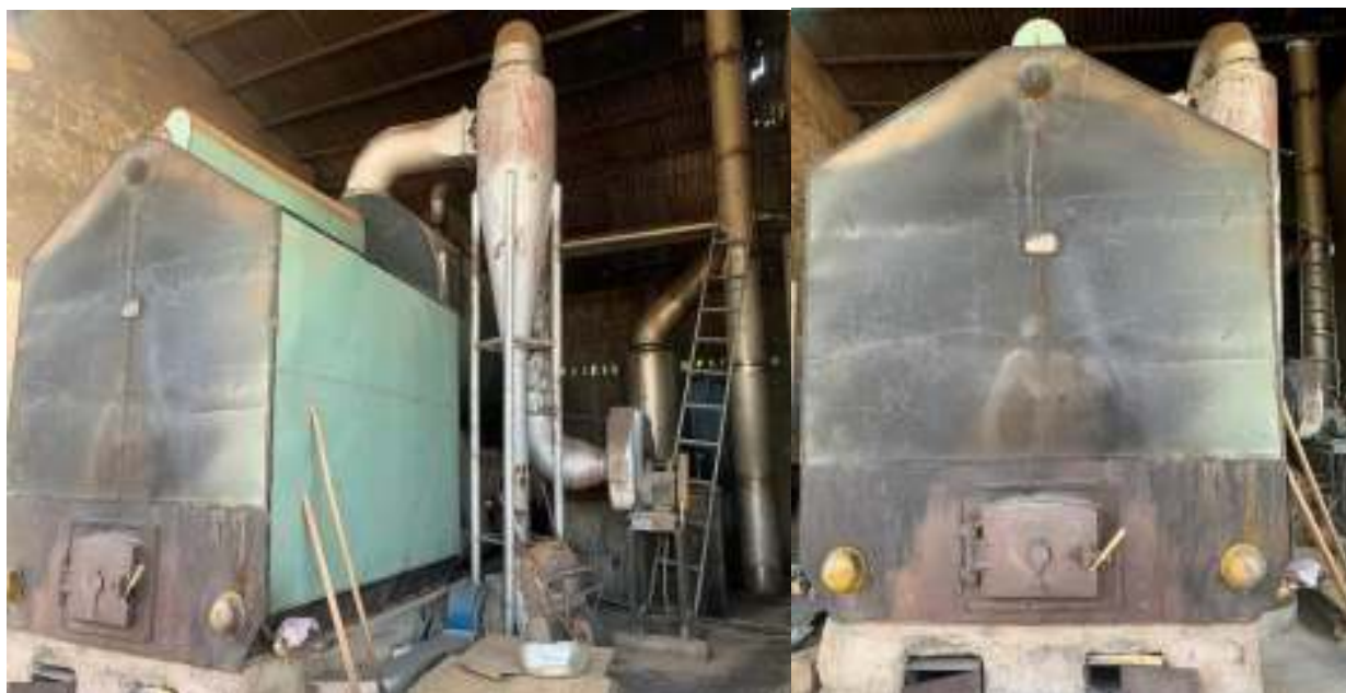
Hình 3. 6. Hệ thống xử lý khói thải lò đốt
