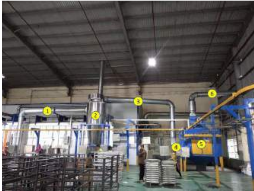
Hình 3.5. Hệ thống xử lý khí thải từ buồng phun sơn tĩnh điện tại Cơ sở
