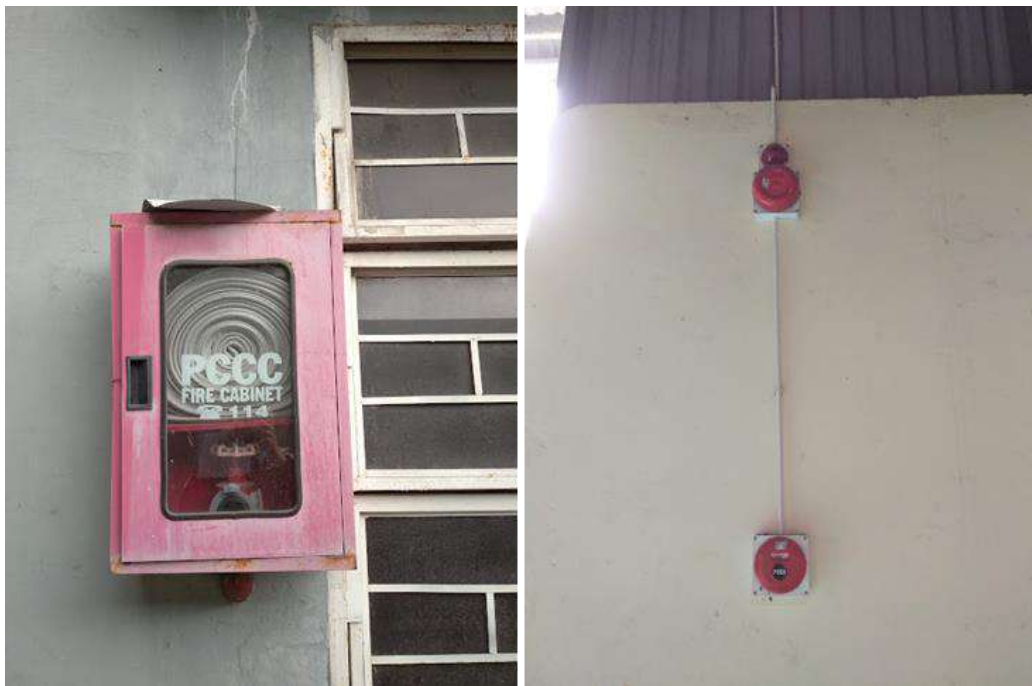
Hình 3.8. Hệ thống PCCC tại Cơ sở
