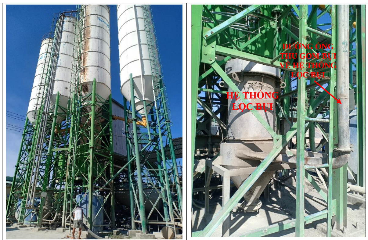
Hình 3.11. Thiết bị xử lý bụi và silo nguyên liệu
