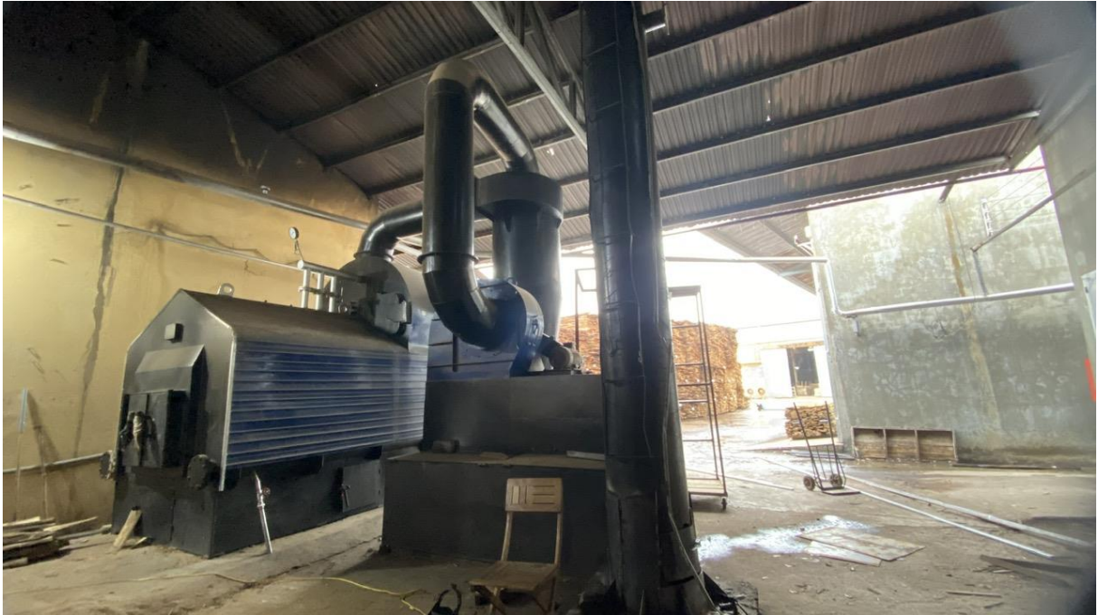
Hình 3.4. Công trình xử lý khói thải lò hơi tại cơ sở
