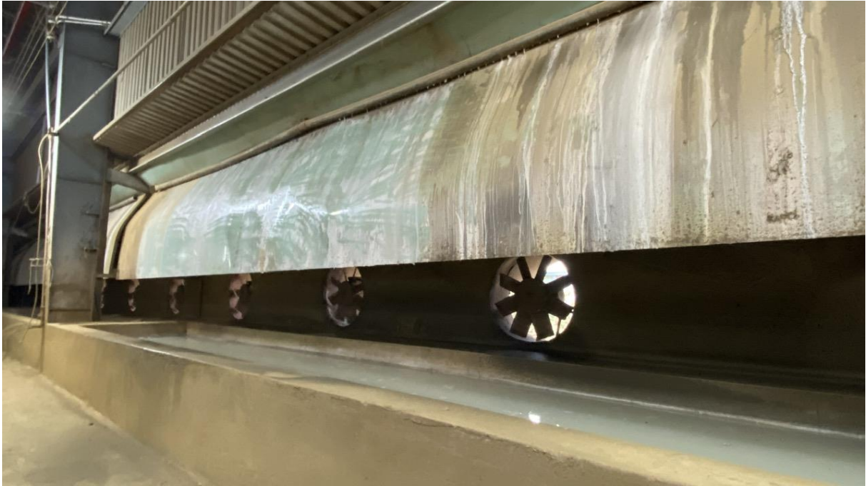
Hình 3.8. Công trình màng nước xử lý hơi dung môi, bụi sơn trong dây chuyền sơn của cơ sở
