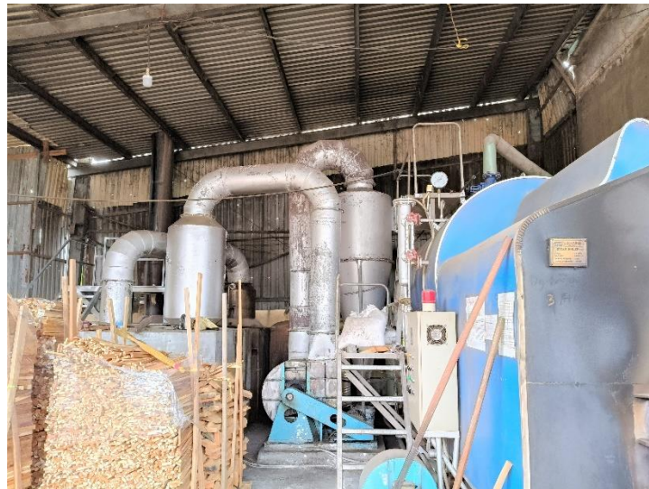
Hình 5. Hình ảnh thực tế hệ thống xử lý khí thải lò hơi của nhà máy
