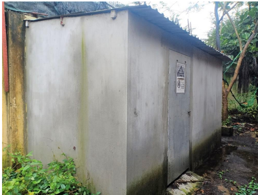
Hình 7. Kho lưu chứa CTNH của nhà máy
