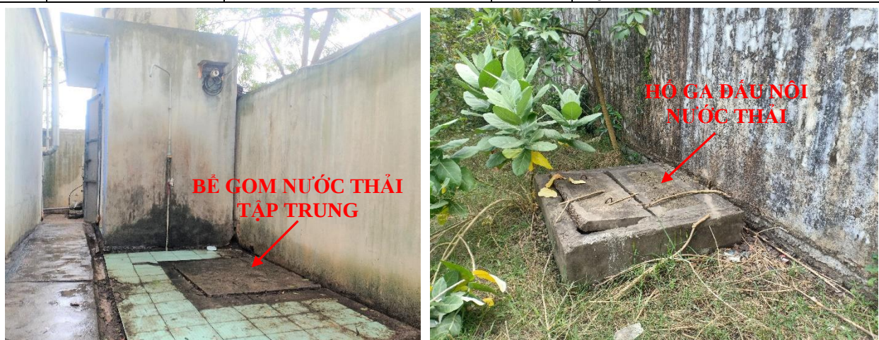
Hình 11. Bể gom nước thải tập trung và hố ga đầu nối nước thải
