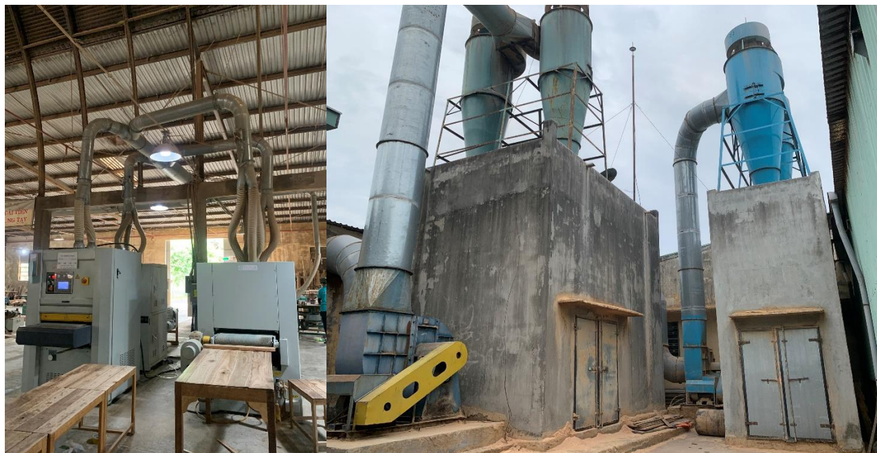
Hình 3. 7. Hệ thống thu gom và xử lý bụi nhà xưởng
