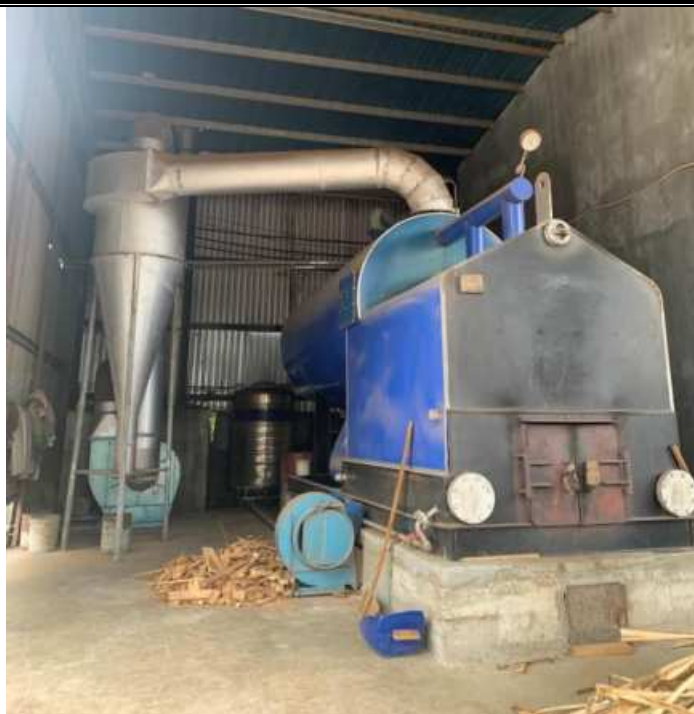
Hình 4. 7. Hệ thống xử lý khói thải lò đốt
