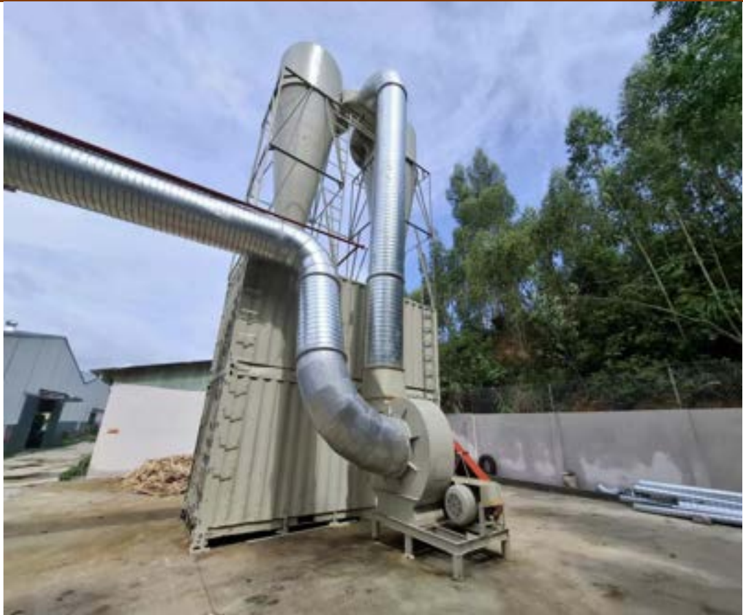
Hình 4. 6. Hệ thống xử lý bụi gỗ
