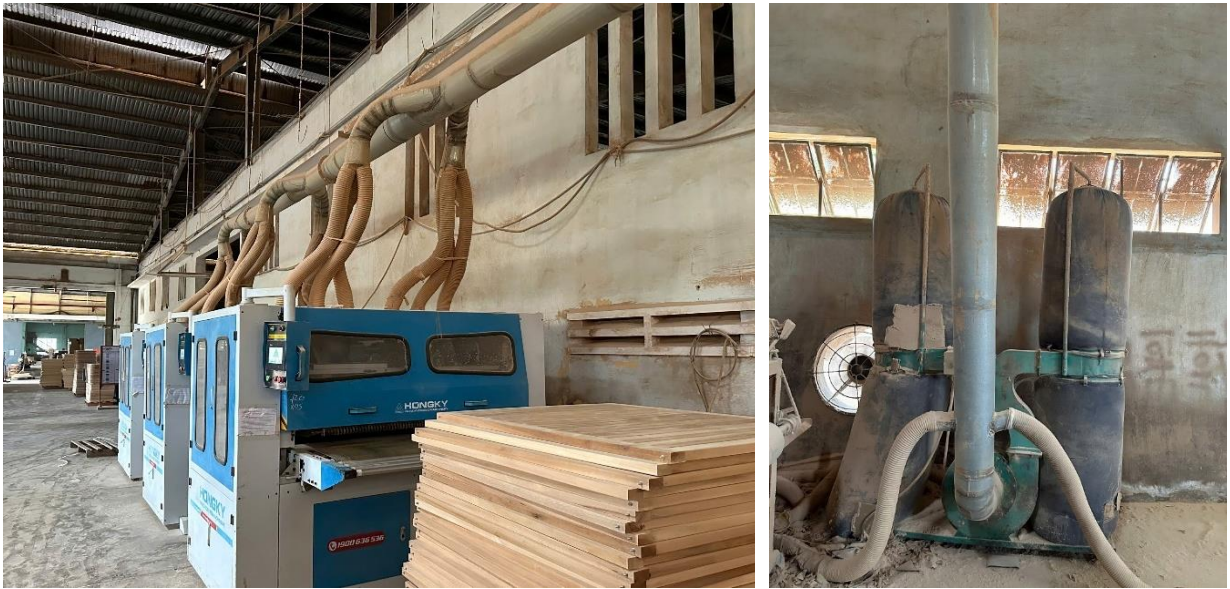
Hình 3.10. Hệ thống thu gom bụi từ máy chà nhám và quạt hút bụi túi vải
