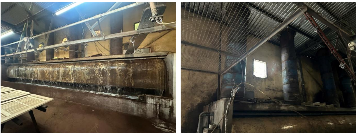
Hình 3.12. Hệ thống phun sơn màng nước tại nhà máy.
