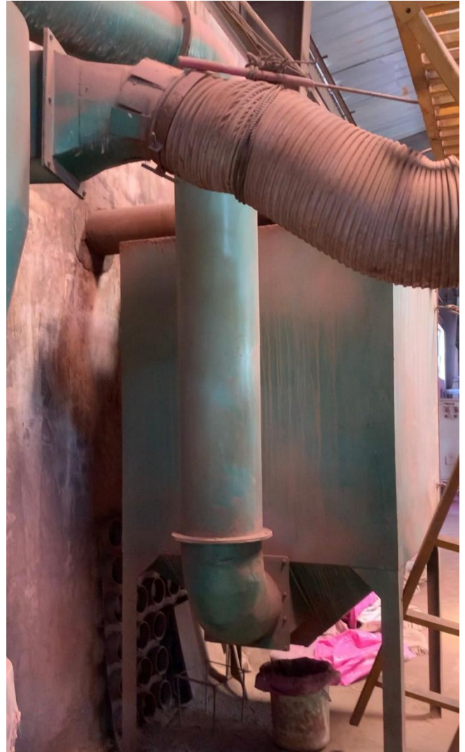
Hệ thống chứa filter thu hồi bụi
