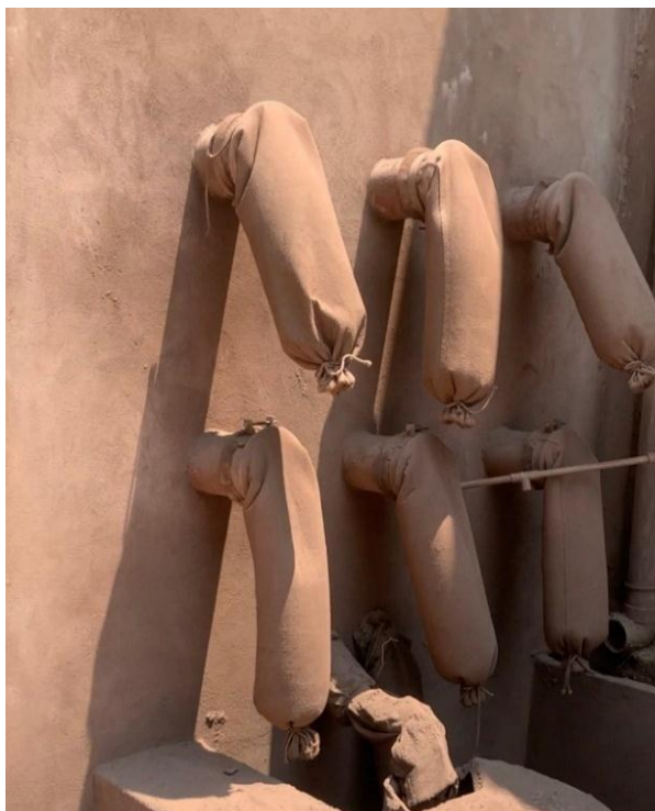
Hệ thống lọc túi vải
