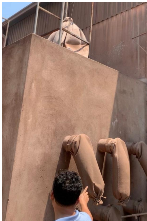
Hệ thống lọc túi vải
