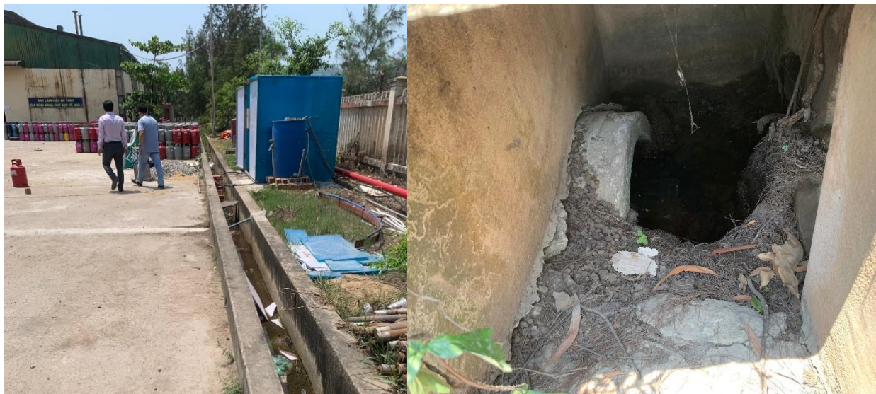
Hình 3.2: Hình ảnh mạng lưới thoát nước và vị trí cửa xả tại cơ sở
