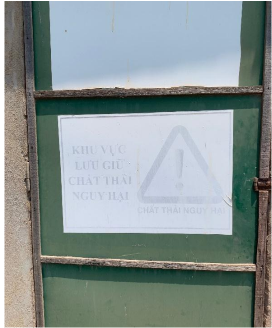
Kho chứa chất thải nguy hại tại cơ sở
