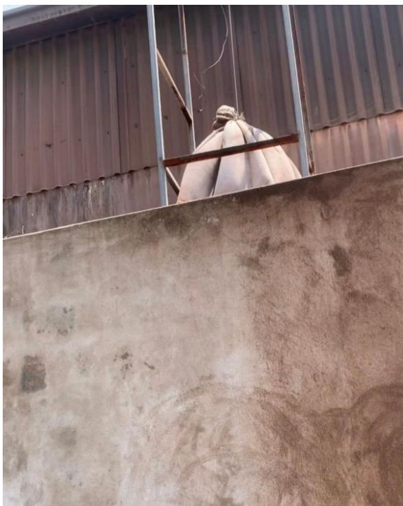
Hệ thống lọc túi vải
