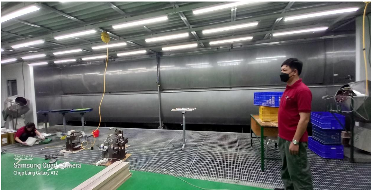
Hình 3. 8. Hệ thống thu gom và xử lý bụi công đoạn phun sơn
