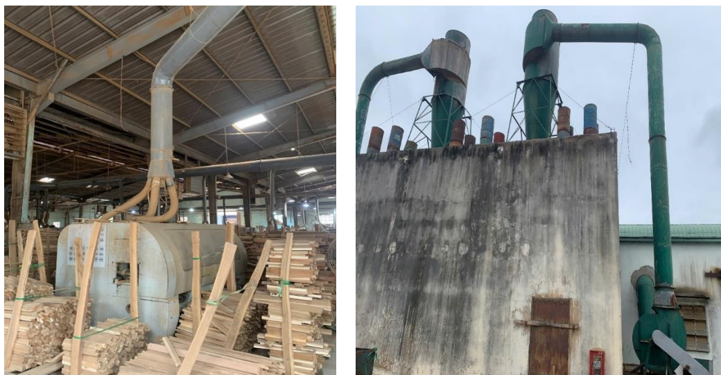
Hình 3. 6. Hệ thống thu gom và xử lý bụi nhà xưởng
