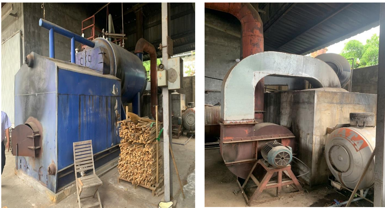
Hình 3. 9. Hệ thống xử lý khói thải lò hơi
