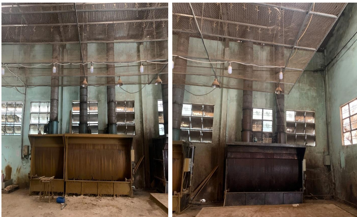
Hình 3. 7. Hệ thống thu gom và xử lý bụi công đoạn phun sơn
