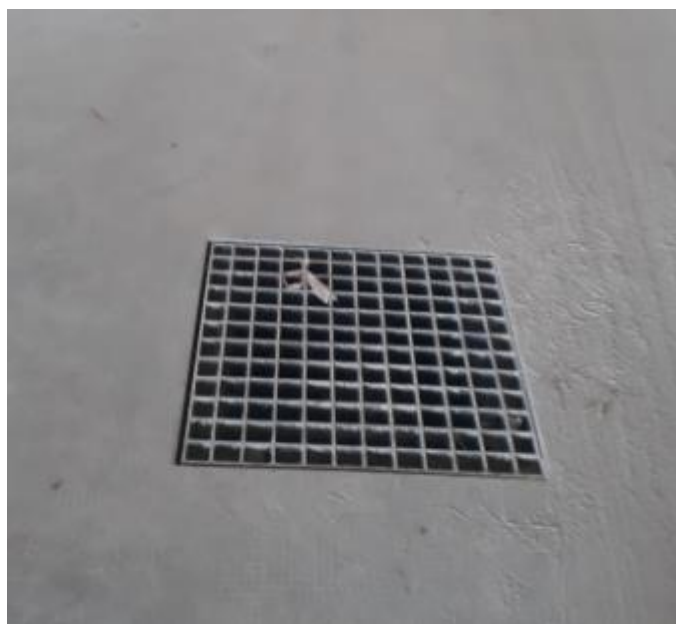
Hình IV.21. Hố thu gom tại khu nhà tiếp dung môi
