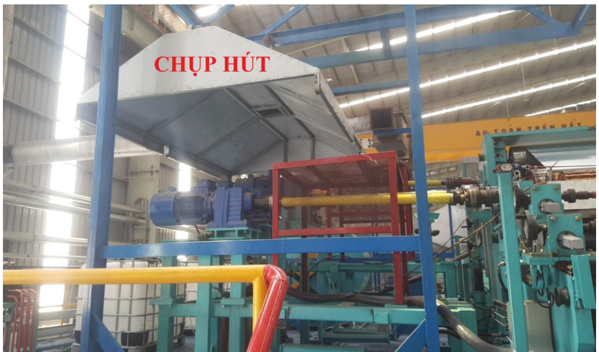
Hình 3. 19 Hệ thống chụp hút tại buồng sấy tôn đã sơn
