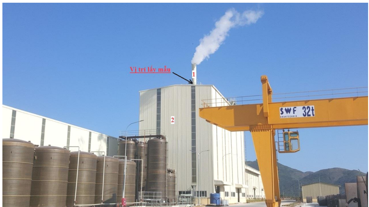
Hình 3. 15 Khu vực xử lý hơi axit phát sinh từ hệ thống tái sinh axit
