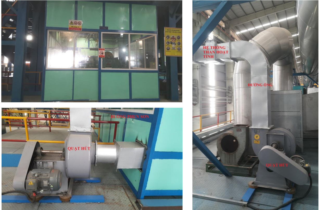
Hình 3. 18 Hệ thống xử lý hơi dung môi từ quá trình sơn trong dây chuyền mạ màu
