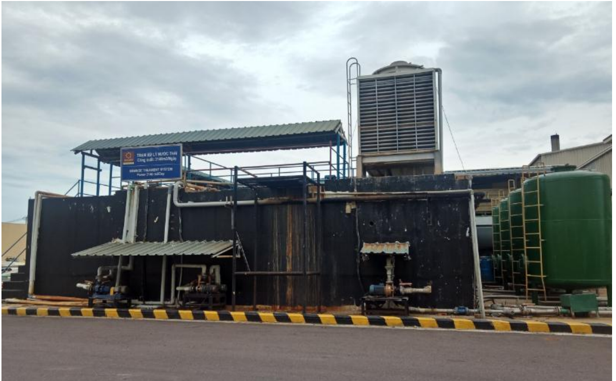
Hình 3. 10 Khu vực xử lý nước thải sản xuất của dự án
