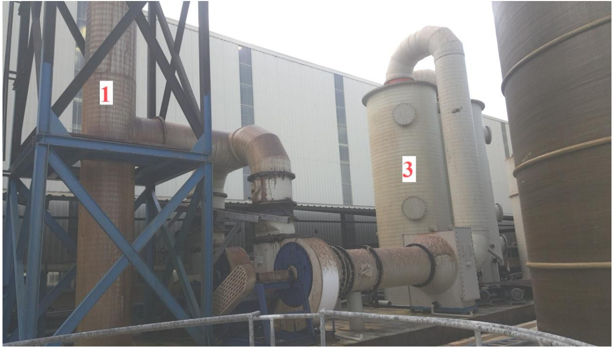
Hình 3. 13 Khu vực xử lý hơi axit phát sinh từ quá trình tẩy rỉ
