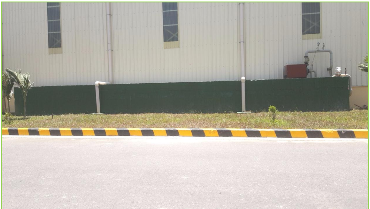
Hình 3. 23 Bể nước phòng cháy chữa cháy
